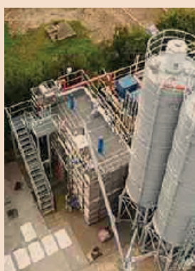
Impianto Green Eco
